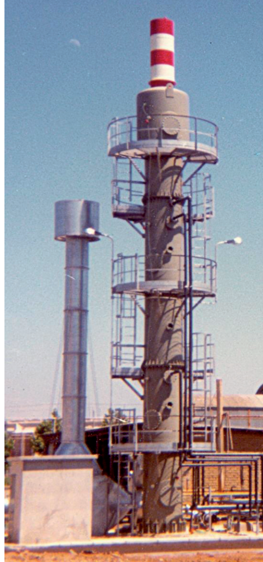
Fig. 2 – Apparecchiatura tipica dell'industria di processo: scrubber installato in un impianto RIR (Rischio di Incidenti Rilevanti), autoportante, su una fondazione isolata profonda del tipo a plinto con solettone in conglomerato cemento armato in prima approssimazione considerato come rigido; i risultati dei calcoli sono riportati nel par. 3
